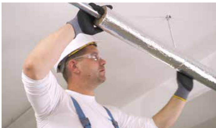
Isolatie van leidingen
