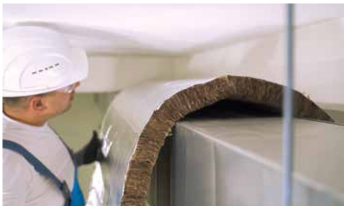
Isolatie van rechthoekige luchtkanalen
