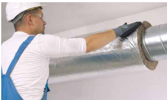
Isolatie van ronde luchtkanalen
